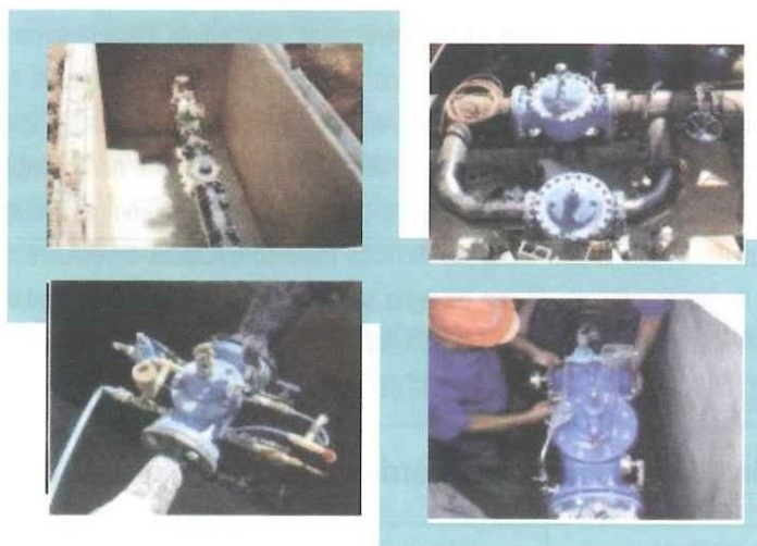
Figura 8: Válvula Redutora de Pressão (VRP) implantada em rede de distribuição de água.
