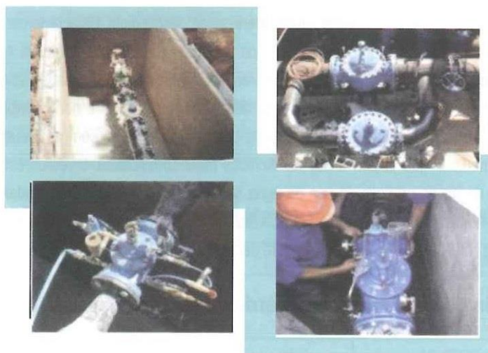
Figura 8: Válvula Redutora de Pressão (VRP) implantada em rede de distribuição de água.
